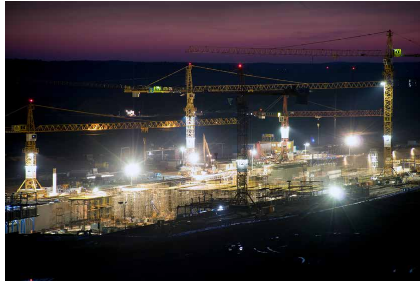
Der Terminalrohbau im Licht der Dämmerung und der Baustrahler: Leinemann Partner sind vom ersten Tag an dabei
