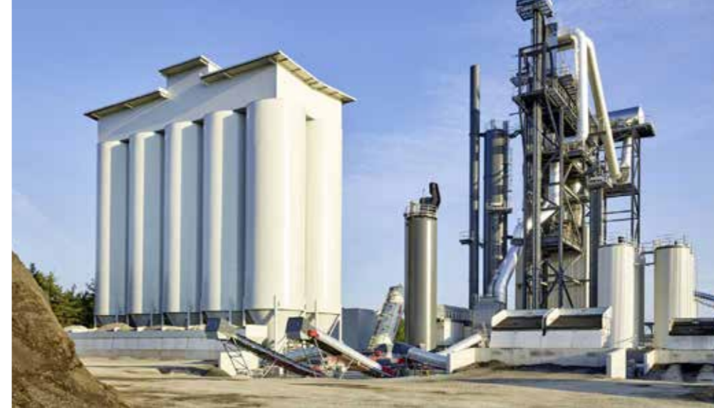
Asphaltmischanlage: die kurzfristige Verdoppelung der Bitumenpreise schlägt voll auf den Asphaltpreis durch
